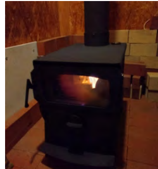
利用推進事業補助金により設置された薪ストーブ
