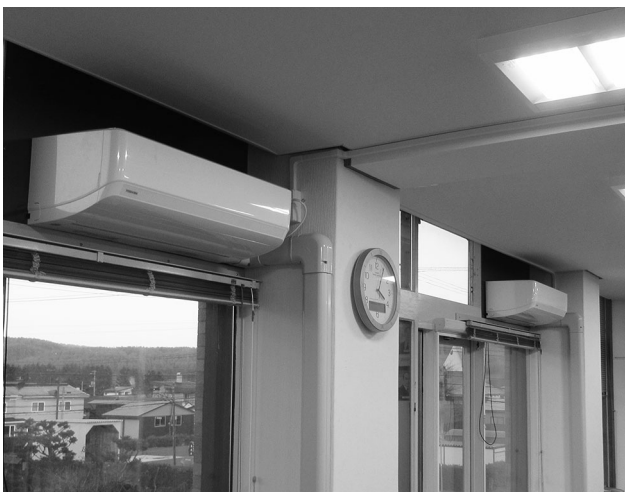
役場2階に設置されたエアコン
