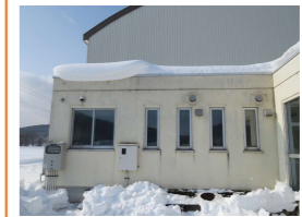
①屋根からの落雪
