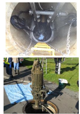
マンホールポンプ所内状況及びマンホールポンプ
