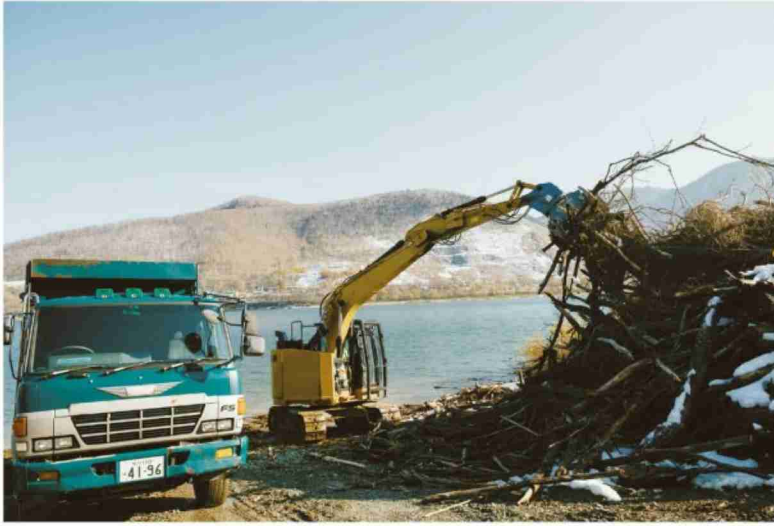
南富良野町の市街地は、以前と変わらない状態まで復旧しましたが、空知川の上流部護岸の大部分は、いまだ大きく崩れた土砂や倒木・流木が積み重なったままの状態です。
