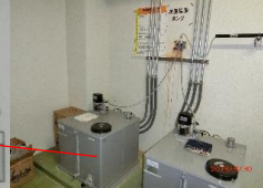
電機制御盤 (ペーパーを上げる装置)
